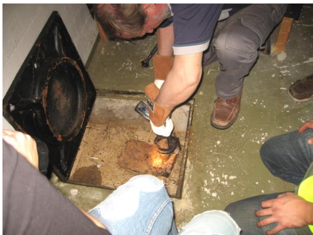
Viemärin sulkuventtiilin avausyritys.
