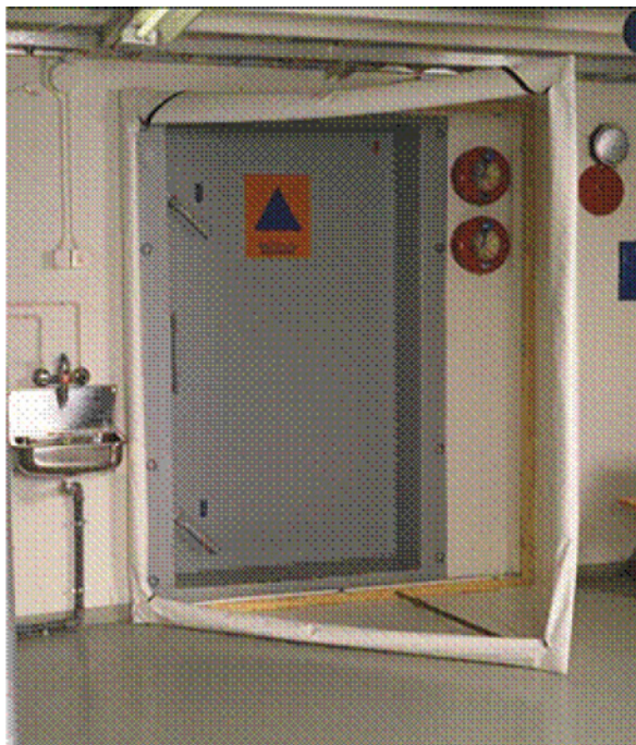
Kuva 34. S1- ja K-luokan väestönsuojan sulkuteltta.
