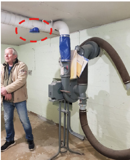
Kuva 129. Vuoden 1971 venttiili asennettu alas.
