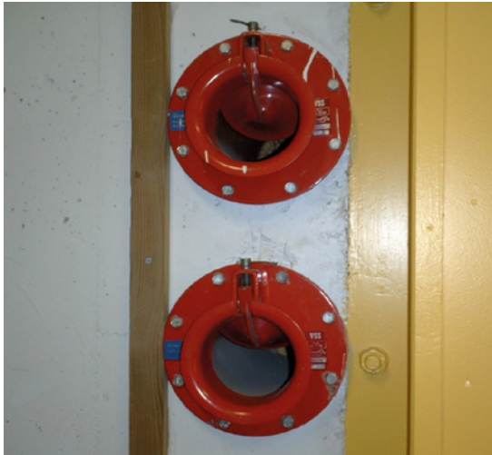
Kuva 70. S1-luokan ylipaineventtiili sulkuteltan kohdalla.
