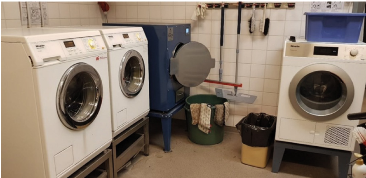
Kuva 63. Pyykinpesutila, jossa on suuri ilmanvaihdon tarve.
