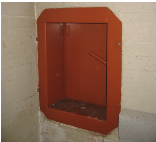
Kuva 104. Luukku aukeaa hätäpoistumiskäytävään.
