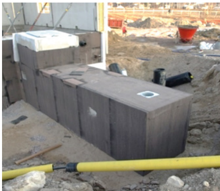
Kuva 101. Elementeistä tehty hätäpoistumiskäytävä.
