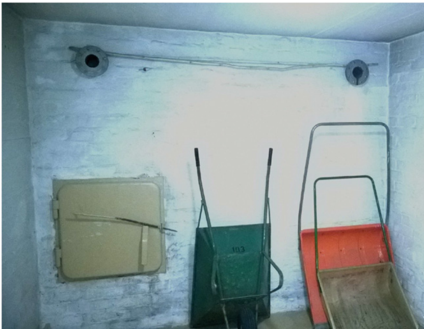
Kuva 2. Väestönsuojassa oli läpimenot ilmanvaihtolaitteille, mutta laitteet puuttuivat.
