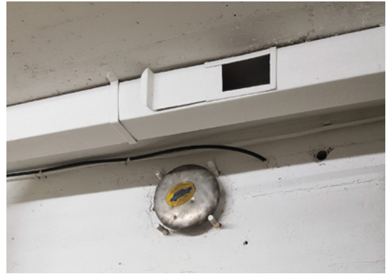
Kuva 128. C-luokan suojan jakokanava 1963.
