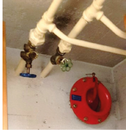
Kuva 49. Putki suoraa seinän läpi.
