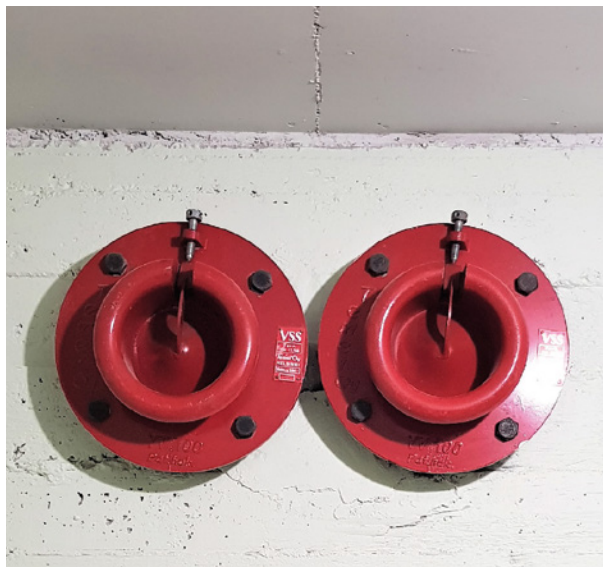
Kuva 73. C-luokan loppuvaiheen ylipaineventtiili v. 1971.
