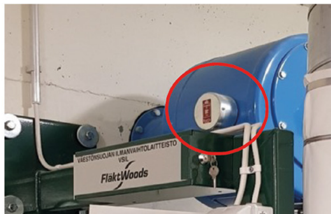
Kuva 81. Tuloilman lämmitin ja suodattimen kuivaus.
