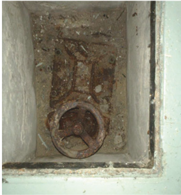
< Kuva 50. Ruostunut viemärin sulkuventtiili.
