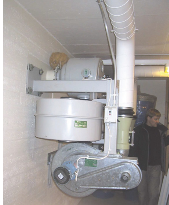
Kuva 87. S1-luokan 80-luvun ilmanvaihtolaite.
