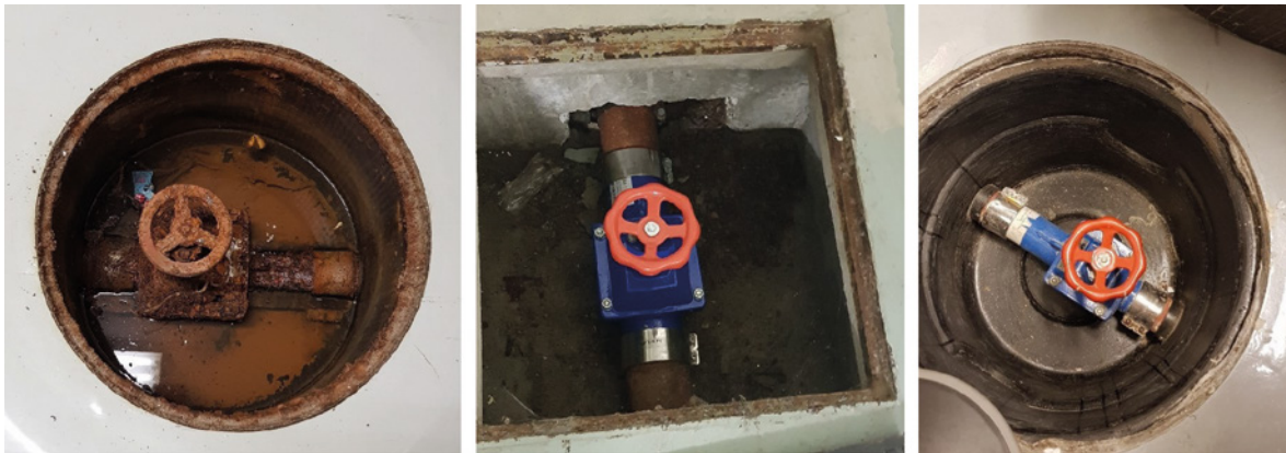
Kuvat 159–161. Muutamassa venttiilikaivossa oli vettä, mutta venttiili toimi ainakin vielä moitteettomasti.
