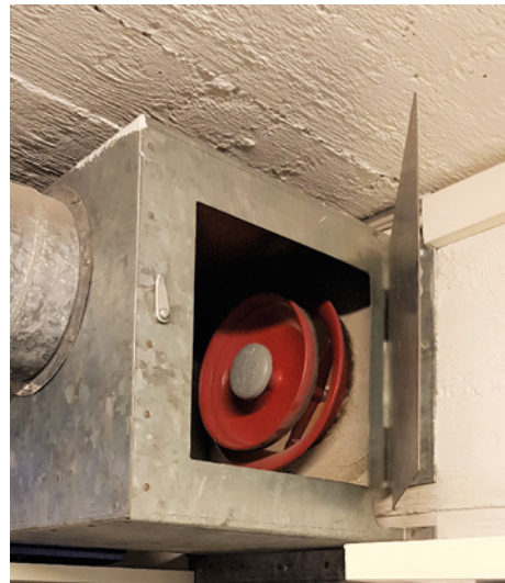
Kuva 37. Sulkuhuoneen kaasutiivis venttiili kanavassa.
