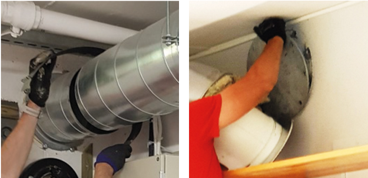
Kuvat 68–69. Hyvin suuri ilmanvaihtokanava ja sen sulkulevy.
