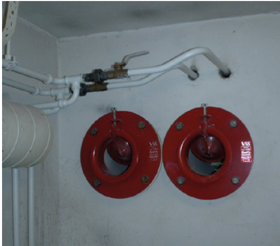
Kuva 57. Lämpöjohtojen läpivienti tiivistämättä.
