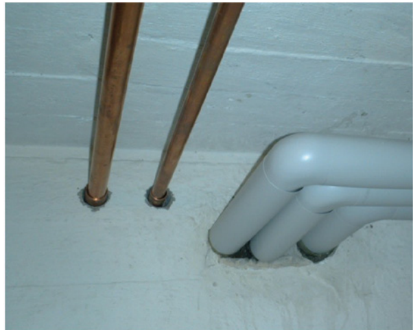
Kuva 58. Uusien vesijohtojen läpimenot tiivistämättä.
