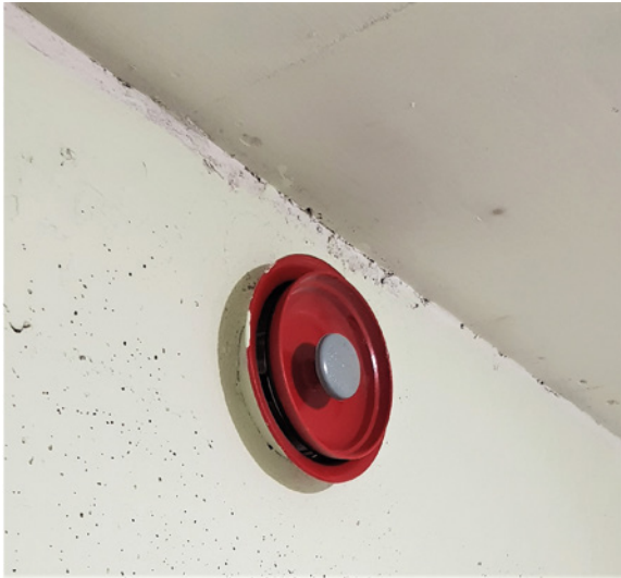
Kuva 36. Sulkuhuoneen kaasutiivis venttiili.
