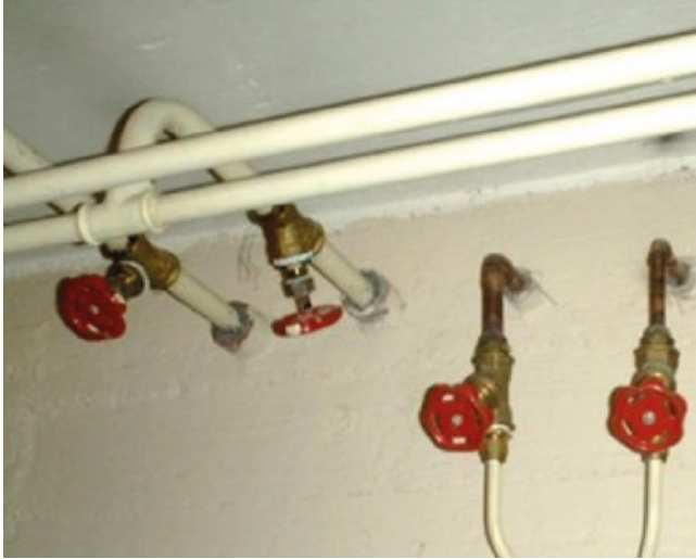
Kuva 48. Lämpö- ja vesijohdon putkiläpivienti holkissa.
