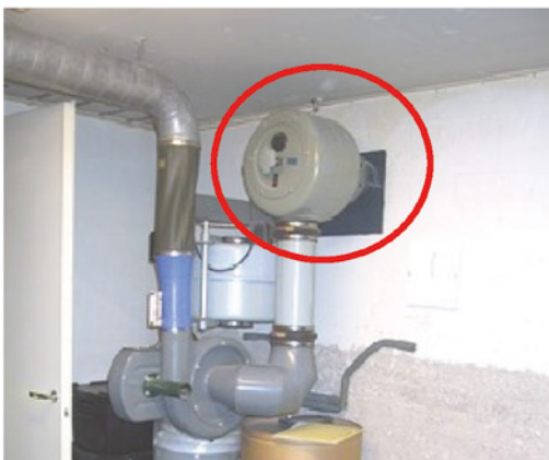
Kuva 80. Ilmanvaihtolaite ja paineventtiili.
