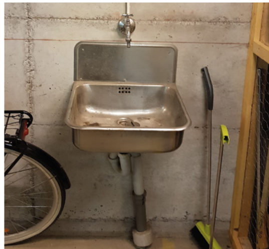
Kuva 47. S1-luokan suojan lavuaari.
